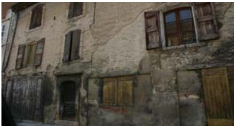
Dégradation et abandon des centres anciens...
