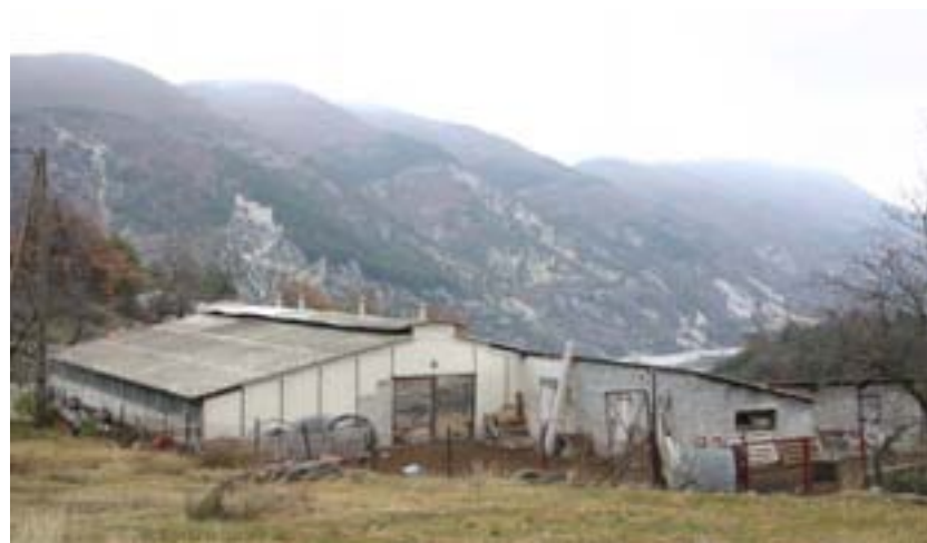
Bâtiments agricoles souvent dégradés avec des abords peu soignés
